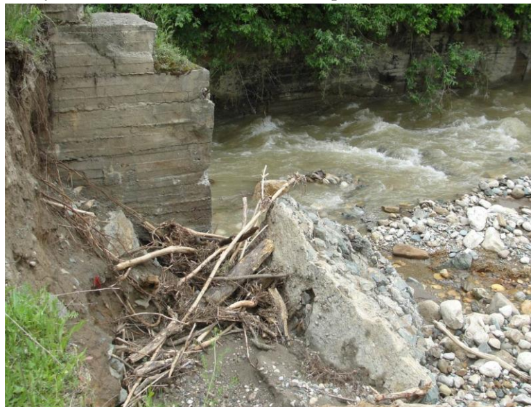
Рис. 2. Подмыв откоса и разрушение примыкания подпорной плотины к порталу тоннеля 2 селем 21.05.2014 г. Фото Э.В. Запорожченко 03.06.2014 г.
