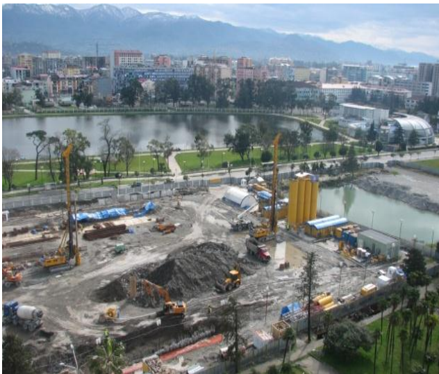
Рис. 3. Начало работ по устройству фундаментов гостиницы «HILTON» в г. Батуми. (Хорошо виден высокий уровень стояния грунтовых вод)
