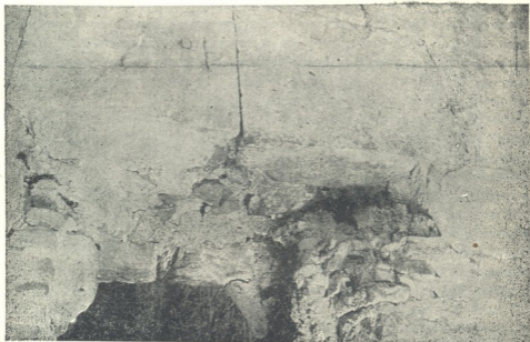
Рис. 14. Верхняя часть проломанной в северный придел двери.
