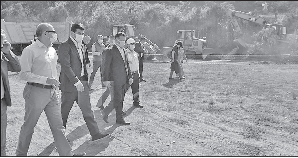
საქართველოს იპოდრომის ტერიტორიაზე თბილისის ცენტრალური პარკის მოწყობის სამუშაოები დაიწყო. პარკი 36 ჰექტარზე განთავსდება და მისი მოწყობისთვის სახსრებს ფონდი „ქართუ“ გაიღებს.
