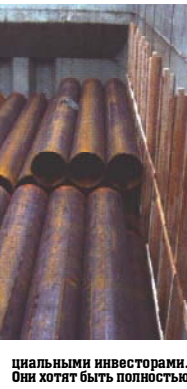
— для экспортного трубопровода «Баку-Тбилиси-Джейхан».
