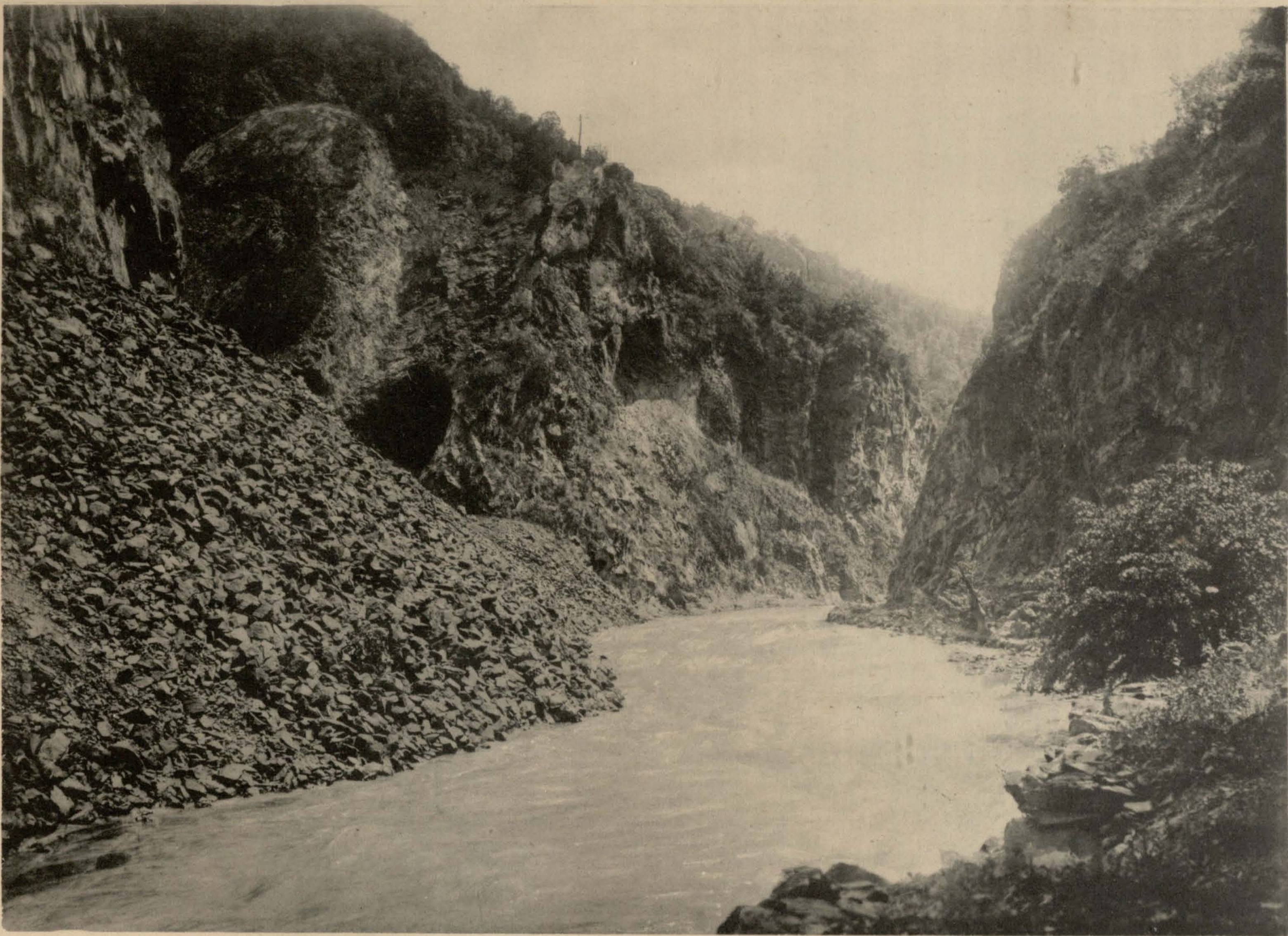
Расщелина между двумя частями тоннеля. Грунтъ изъ тоннеля вываливался черезъ расщелину въ рѣку, вер. 119-ая.
