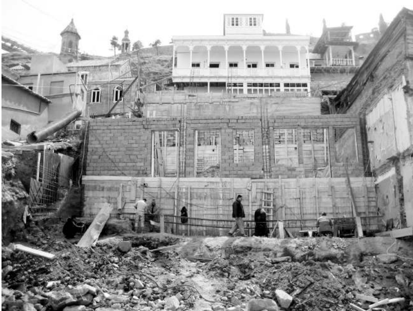
სურ. 54. თბილისი. კლდისუბანი. გომის ქუჩის № 9 სახლის ადგილი. უკანა პლანზე მოჩანს ბეთლემის II შესახვევი № 2/6-ში მდებარე ნაგებობა განახლებული სახით, 2012
