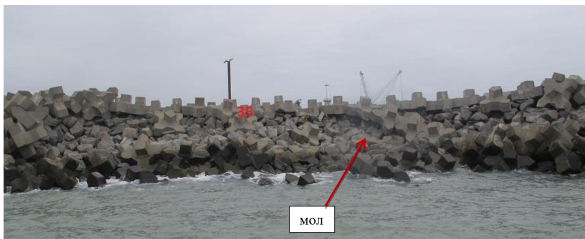
Рис. 1. Разрушенный участок оградительного мола порта Потти
