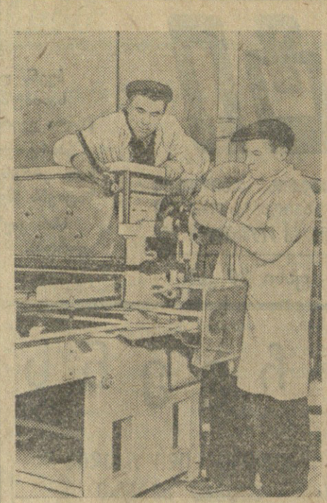
სურამში: კანფეტის ჩამოსხმის მანქანის მონტაჟზე მუშაობენ გეგმარების მდივანი ვ. ხაბარია (მარჯვნივ) და თბილისელი მ. ციციკი.
