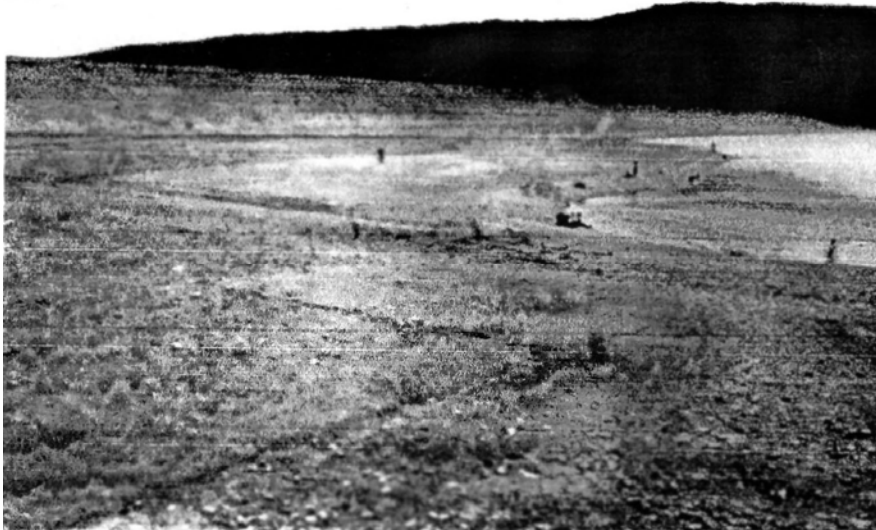
ნახ. 3.8.3. სიონის წყალსაცავის კაშხლის ზედა ბიეფის საფარი ა) სარეაბილიტაციო სამუშაოების ჩატარებამდე; ბ) 2008 წელს ჩატარებული სარეაბილიტაციო სამუშაოების შემდეგ
