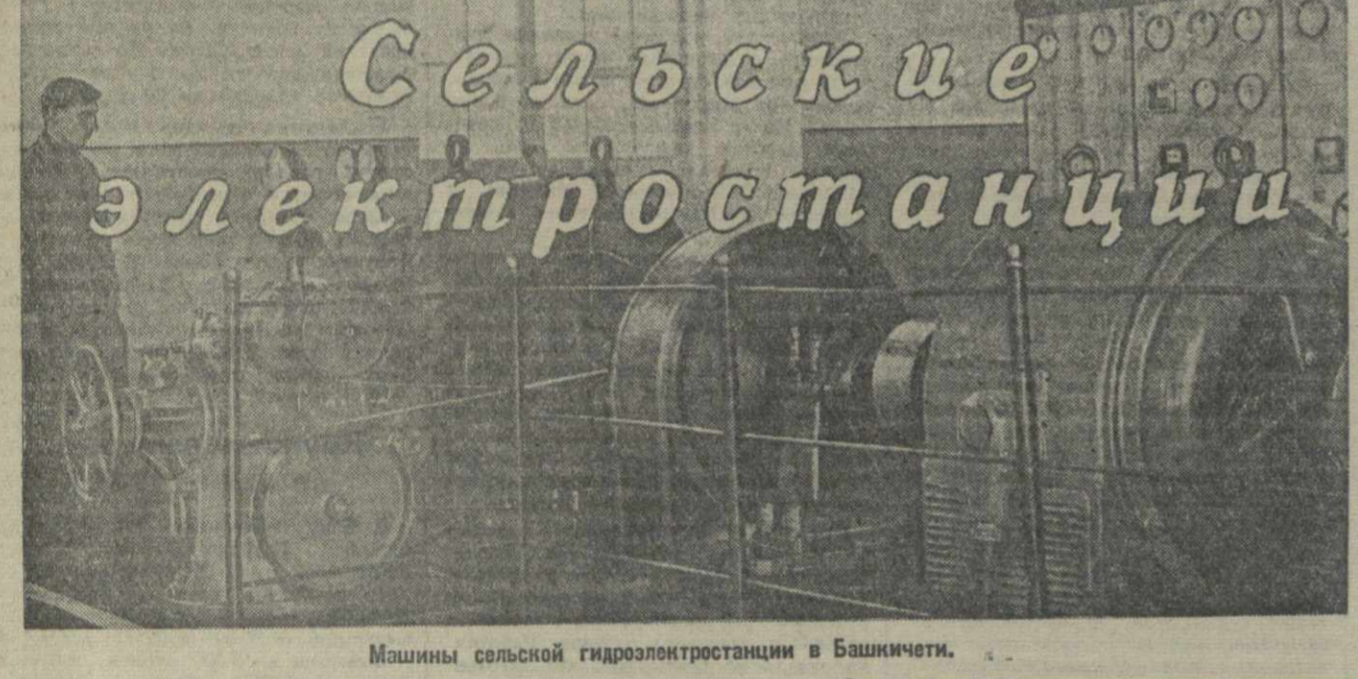
Машины сельской гидроэлектростанции в Башкитчи.
