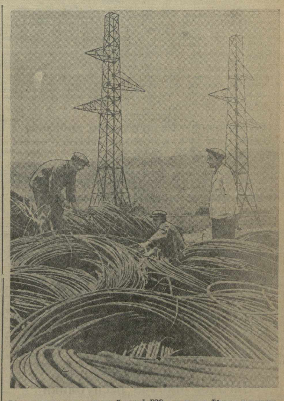
Тбилисская контора строительства Храмовой ГЭС сооружает в Тбилиси подстанцию «Большой Дидубе». На снимке: металлические опоры линии передачи Храмас — Тбилиси, установленные на днях на территории подстанции «Большой Дидубе». Фото М. Квирикашвили.
