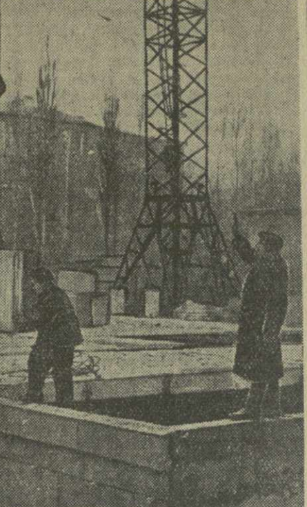
Строительство нового дома из крупных блоков на ул. Палиашвили. Фото Т. Арчвадзе.
