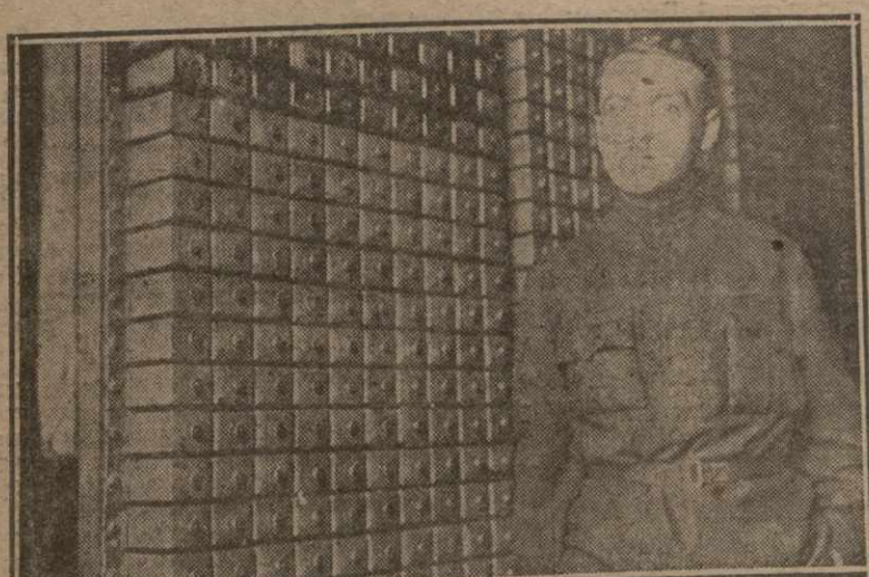
Стойки с автоматическими выключателями.
