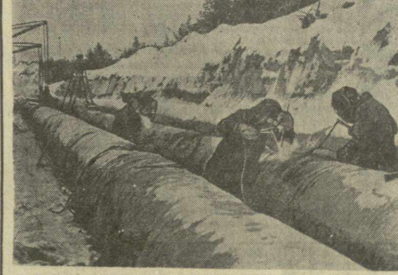
Этот водовод соединит реку Даугава с водохранилищем будущего завода. Сейчас его монтируют.
