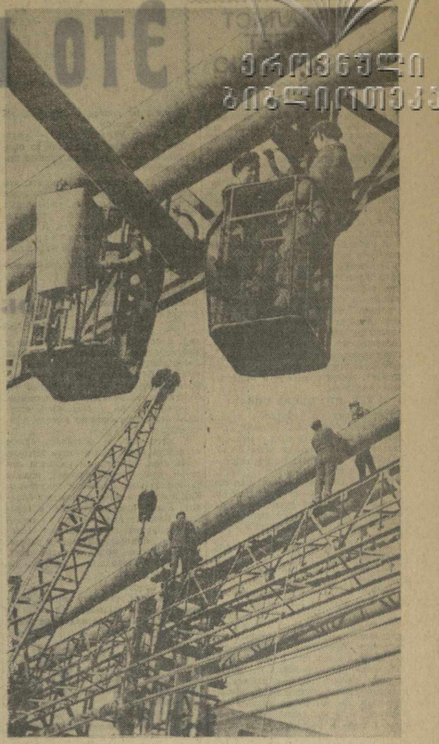
На снимке: монтаж газопроводов на строительстве газопроводного производства в Рустви. Фото С. Киладзе.
