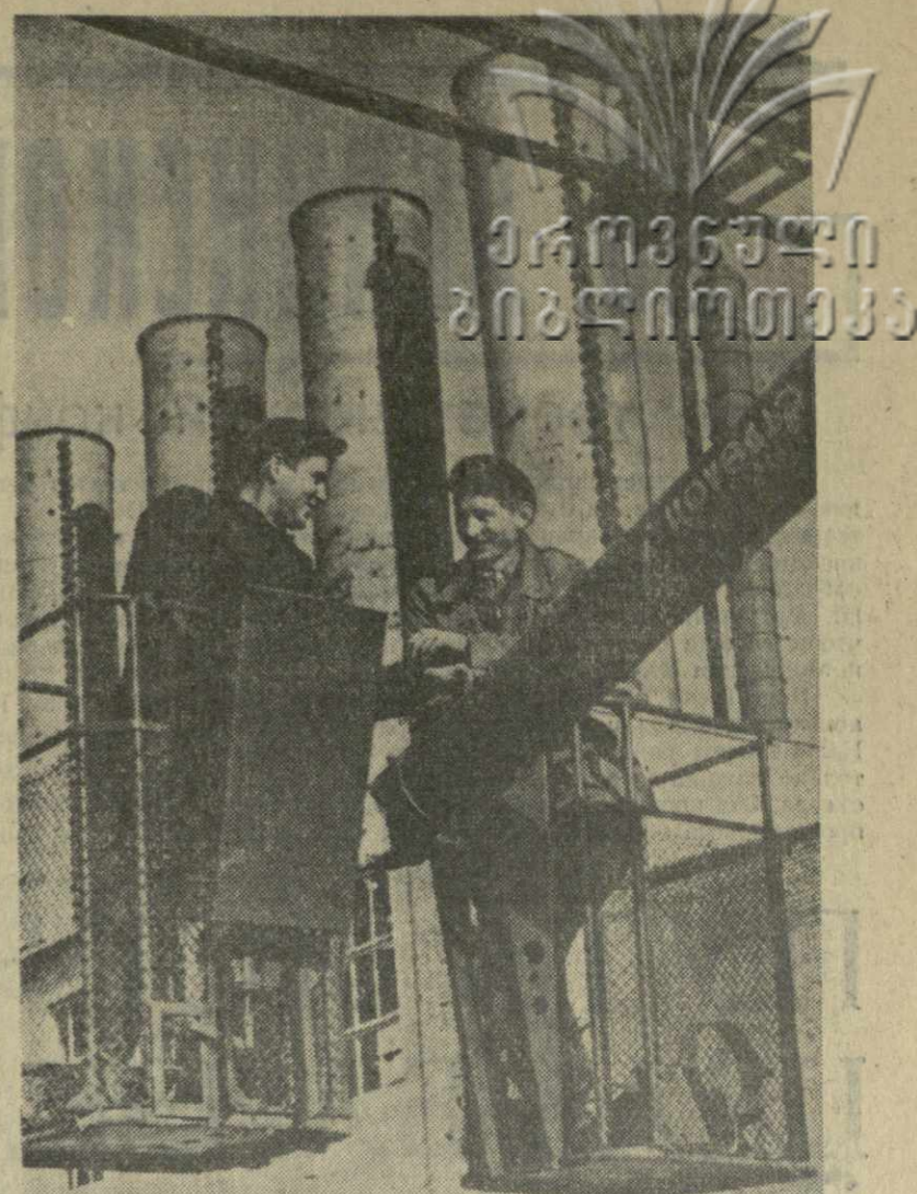
Рустави. Идет монтаж трубопроводов на стройке капроактамового производства. На снимке: передовые слесари-монтажники руставского участка «Металлургпрокатмонтаж» комсомольцы Д. Лябисов (слева) и А. Москвичев.
