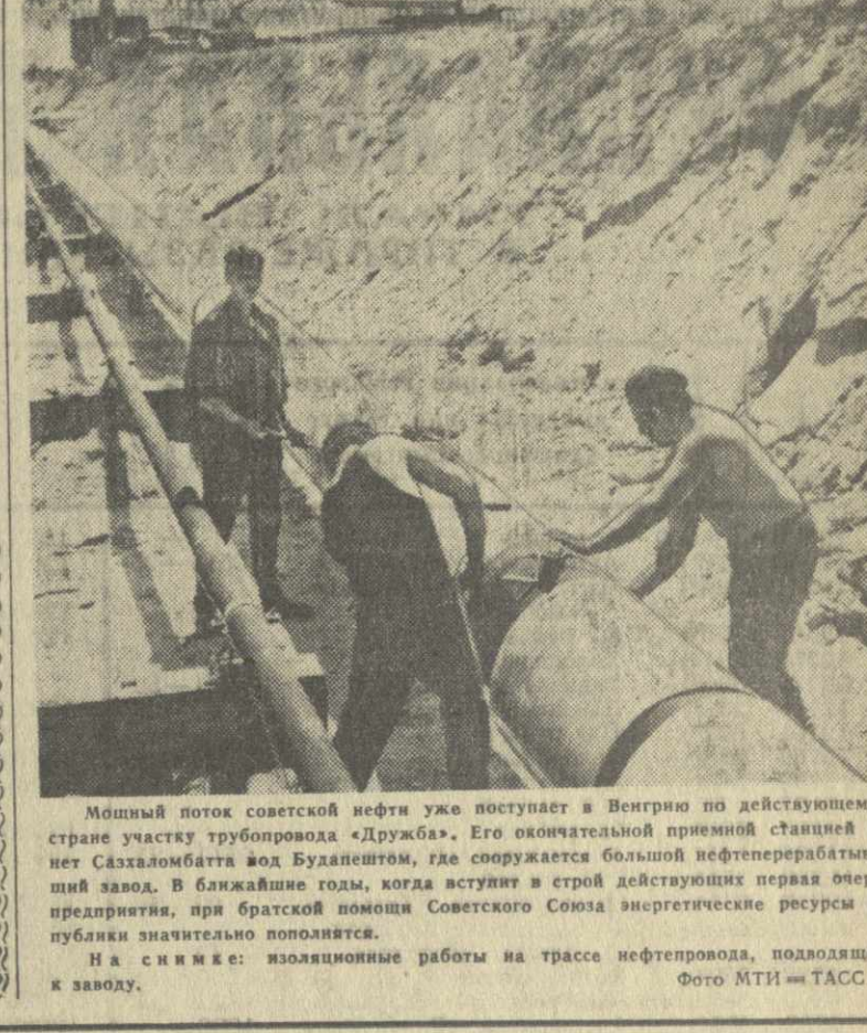
Мощный поток советской нефти уже поступает в Венгрию по действующему в стране участку трубопровода «Дружба». Его окончательной приемной станцией является завод в Бачаломбаце...
