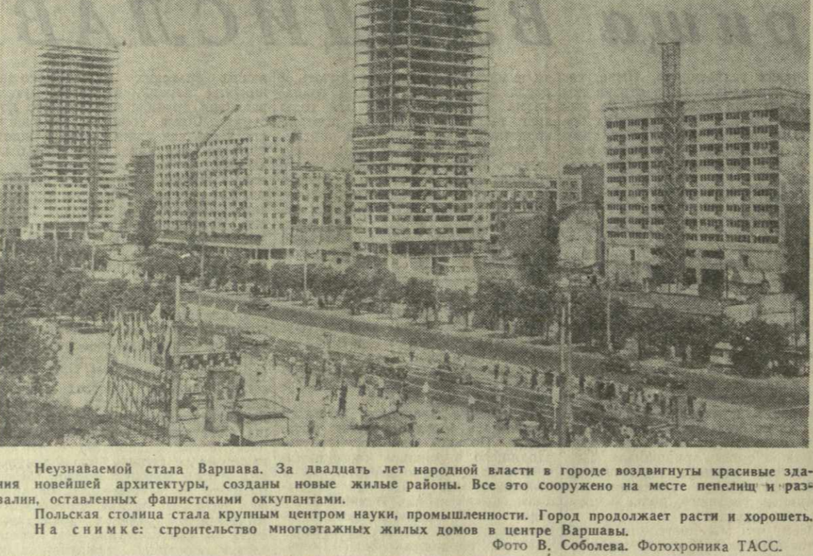
Неузнаваемой стала Варшава. За двадцать лет народной власти в городе воздвигнуты красивые здания новейшей архитектуры, созданы новые жилые районы. Все это сооружено на месте пепелищ и развалин, оставленных фашистскими оккупантами.
