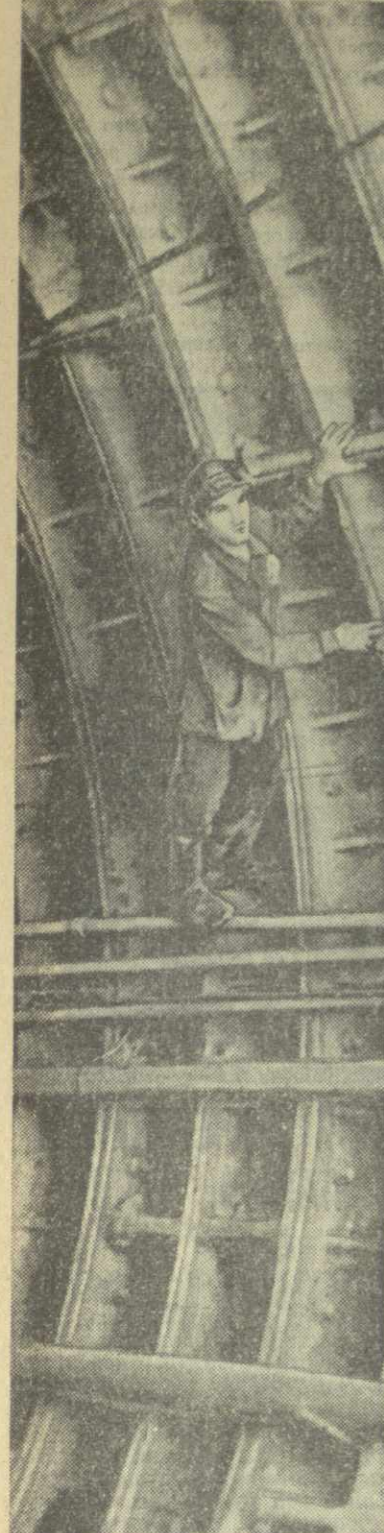
Успешно идет строительство второй очереди Тбилисского метрополитена. Коллектив строителей обязался досрочно выполнить план первого года пятилетия.
