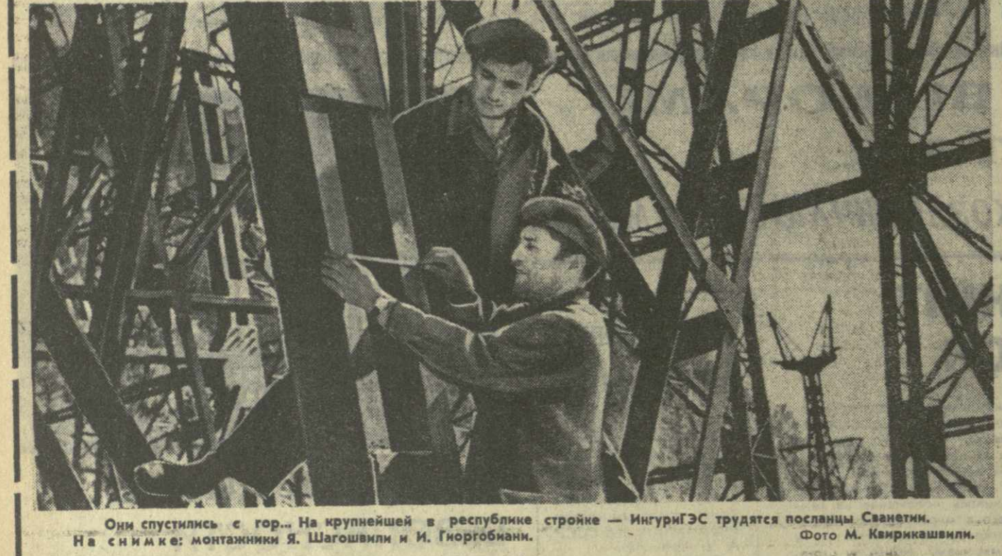
Они спустились с гор... На крупнейшей в республике стройке — ИнгуриГЭС трудятся посланцы Сванетии. На снимке: монтажники Я. Шаговили и И. Гиоргобани.
