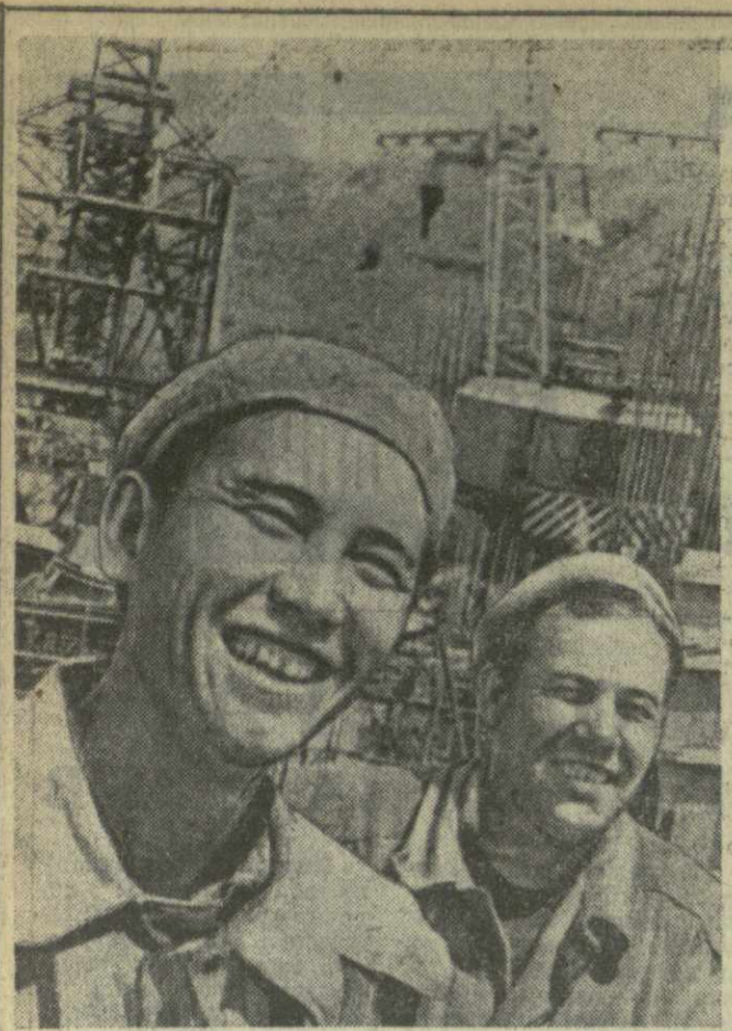
На строительстве Второй перепадной станции Ингульской ГЭС отключаются бетонщик А. Темргалев и арматурщик И. Власов. Соревнуясь в честь 100-летия со дня рождения В. И. Ленина, они выполняют план на 140—160 процентов.
