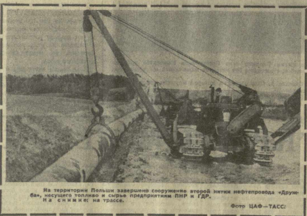
На территории Польши завершено сооружение второй нитки нефтепровода «Дружба», несущего топливо и сырье предприятиям ПНР и ГДР. На снимке: на трассе.
