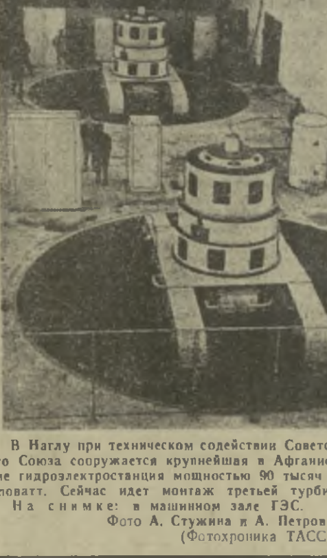
В Нагату при техническом содействии Советского Союза сооружается крупнейшая в Афганистане гидроэлектростанция мощностью 90 тысяч киловатт. Сейчас идет монтаж третьей турбины. На снимке: в машинном зале ГЭС. Фото А. Стужина и А. Петрова. (Фототехника ТАСС).
