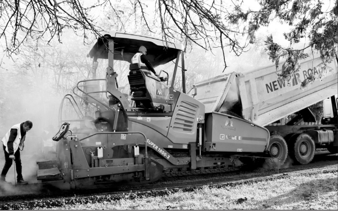
ჩოხატაურის მუნიციპალიტეტში საგზაო ინფრასტრუქტურის განახლება აქტიურად მიმდინარეობს. რეგიონებში განსახორციელებული პროექტების ფონდის და-
