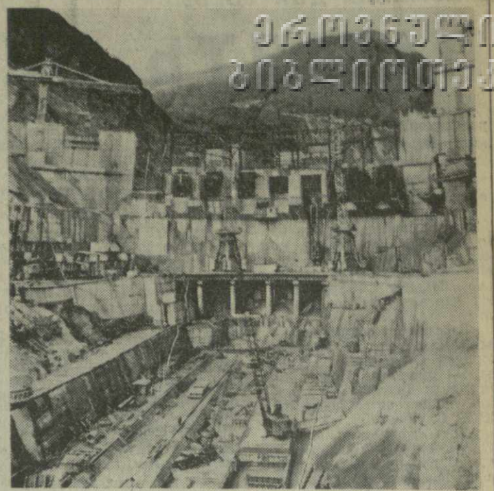
НА ВСЕХ УЧАСТКАХ строительства ИнгуриГЭС сегодня — напряженная пора. Идет подготовка к большому событию...
