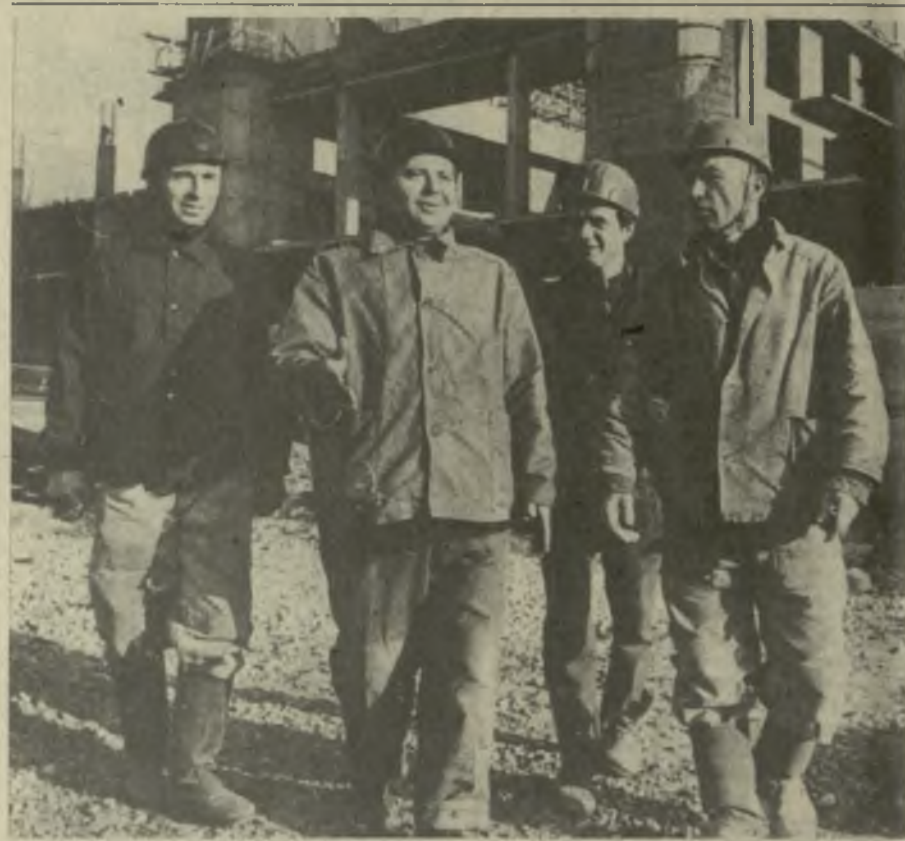
Высокопроизводительно работали на коммунистическом субботнике члены бригады монтажников, принимающие участие в строительстве Тбилисского железнодорожного вокзала. В этот день электромонтер Шота Бедоидзе, монтажник Вахтанг Кобесашидзе, бригадир монтажников Леван Кобесов достигли рекордной производительности труда.
