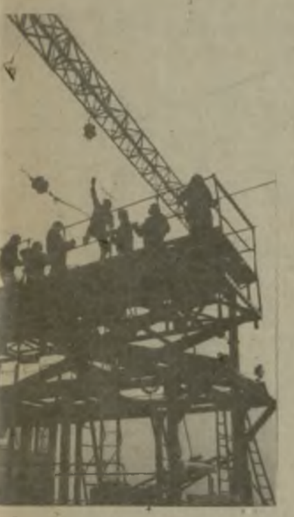
С опережением графика трудятся в эти дни строители трассы Марабда — Ахалкалаки. Уже сооружены четыре станции — Марабда, Цхрадма, Динцкаро и Тетри-Икоро. Протяженность трассы сегодня достигает 30 километров.
