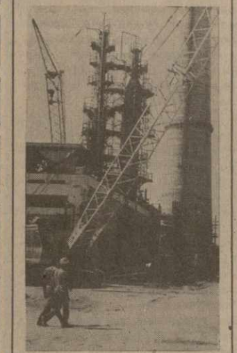
В завершающую стадию вступило строительство крупнейшего на Кубе нефтеперерабатывающего завода, сооружаемого при техническом содействии Советского Союза в Сьенфугосе. За время строительства предрасположена практика создания интернациональных бригад, работу которых отличает высокая производительность труда. Кубинская молодежь имеет возможность осваивать рабочие специальности под руководством опытных советских мастеров.
